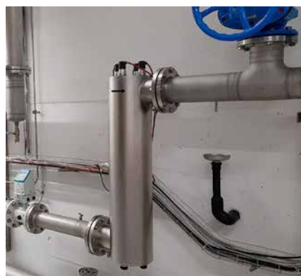
■ Wasserentkeimungsanlage im Reservoir Schwendi
